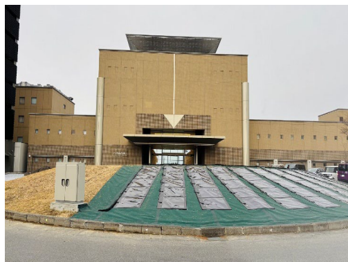
Ｊヴィレッジに設置されたペロブスカイト太陽電池
